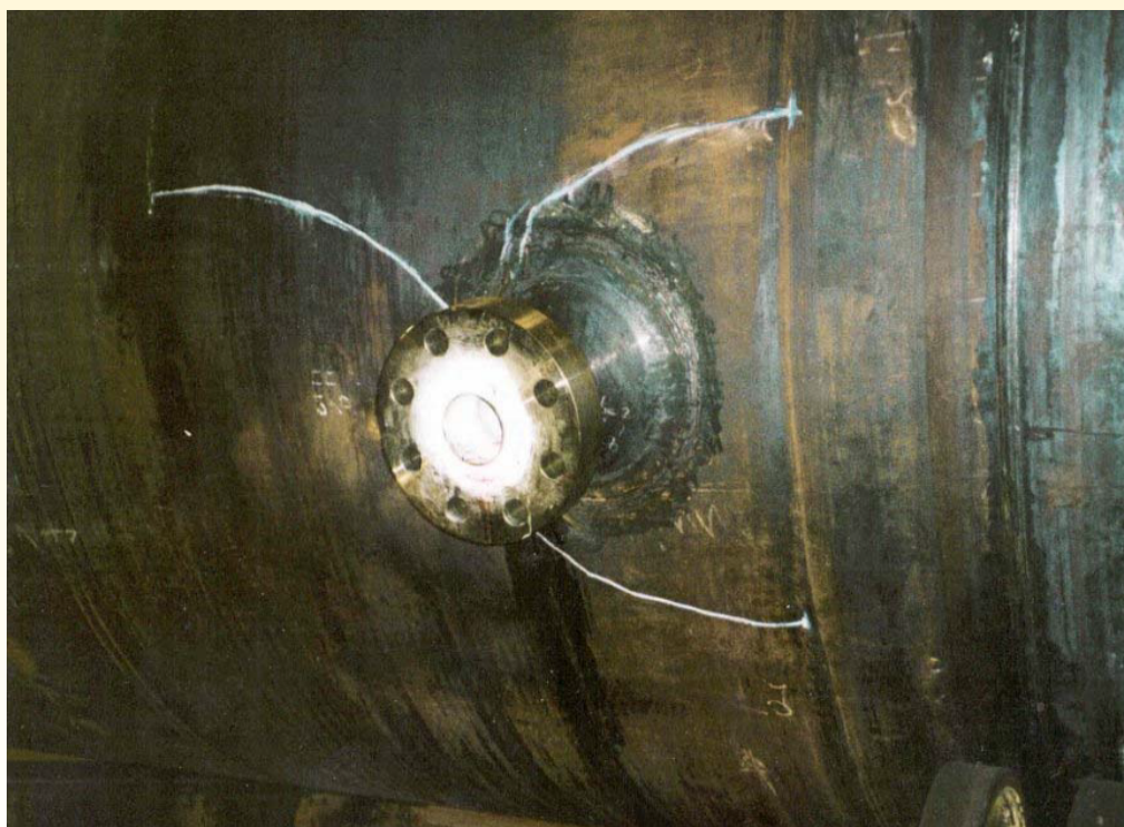
Figura 7.91 - Exemplo de trinca ocorrida na fabricação (reator em 2.25Cr-1Mo-0.25V). Fonte: HAMMERLE, 2012, adaptado pelos autores.
