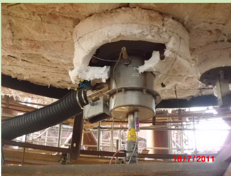
Figura 5.69– Sistema de Aquecimento. Fonte: https://postweldheattreatment.wordpress.com/2011/08/01/pwht-spherical-tank-internal-firing-indonesia/ acessado em 2/7/19.
